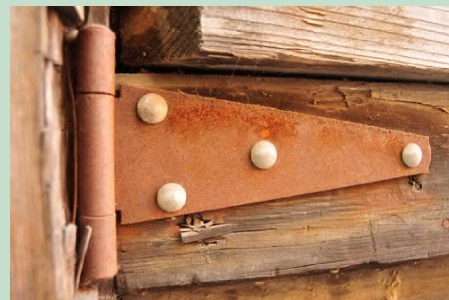
A rusted door hinge.
